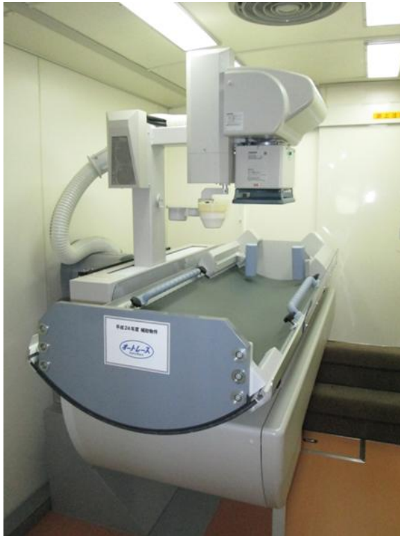
＜X線発生装置・透視撮影台＞
